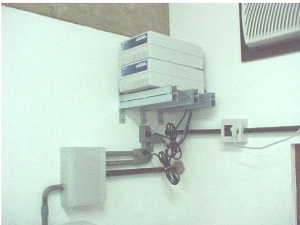
Figura 3.3: No-breaks que ligam os micros à rede elétrica de emergência.
